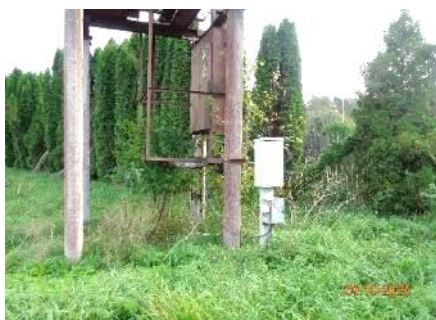
Transformators un elektrosadales skapis
